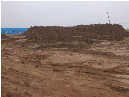
临时堆土无防护
