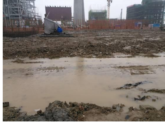
排水沟淤积导致场地积水，尽快疏通
