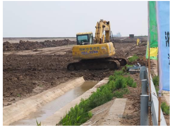
排水沟堵塞，需疏通
