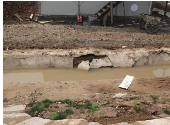
排水沟破损，需补修
