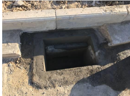
PVC 排水管（2017年12月）
