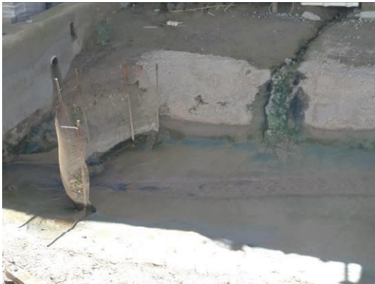
厂区排洪沟淤积
