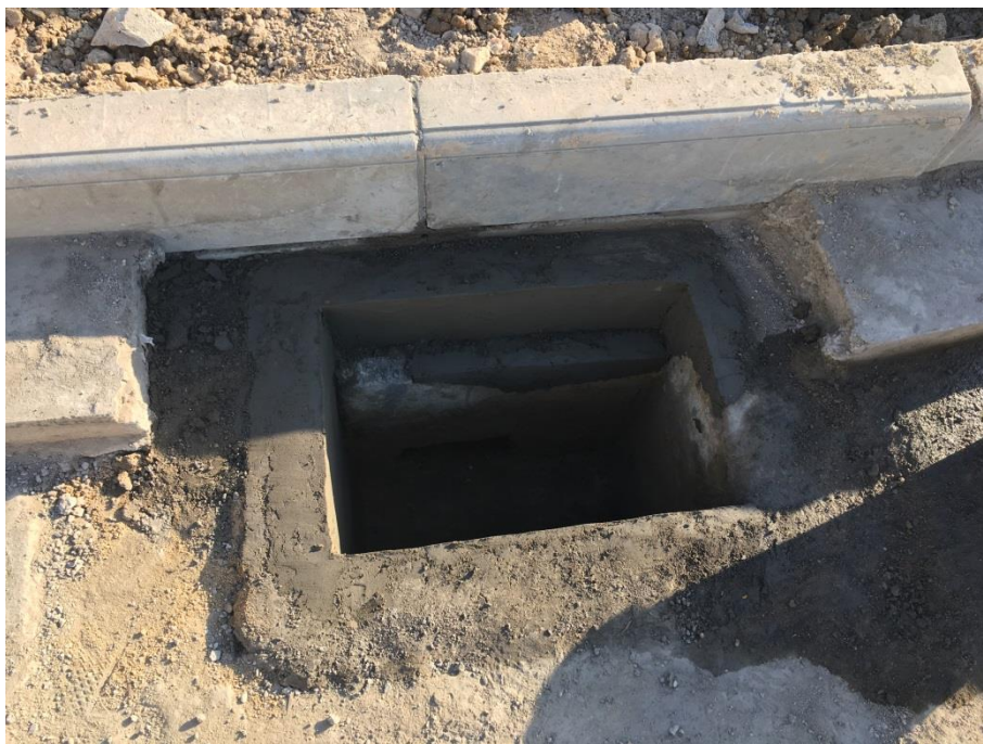
PVC 排水管（2017年12月）
