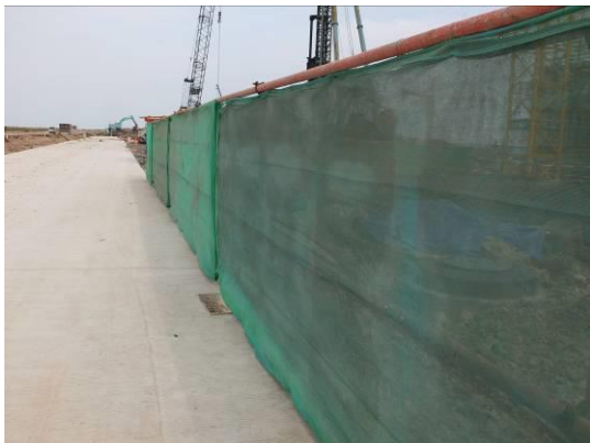
防护网临时拦挡
