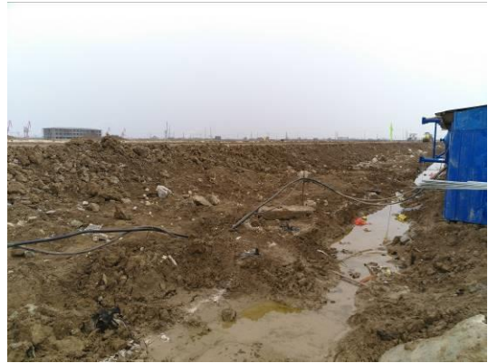
排水沟淤积，建议尽快疏通
