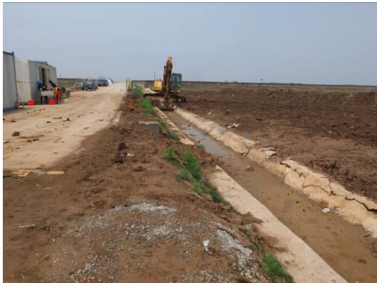
排水沟淤积，需清淤
