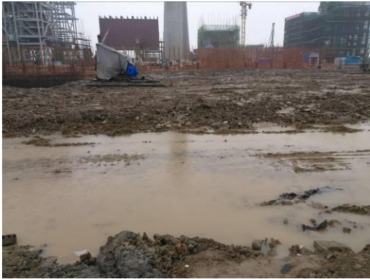
排水沟淤积导致场地积水，尽快疏通
