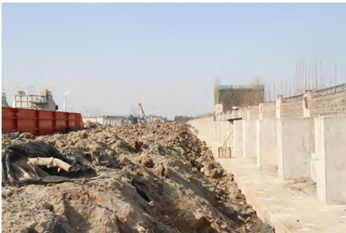
图 3-5 陆域堆场区部分堆土未及时苫盖
