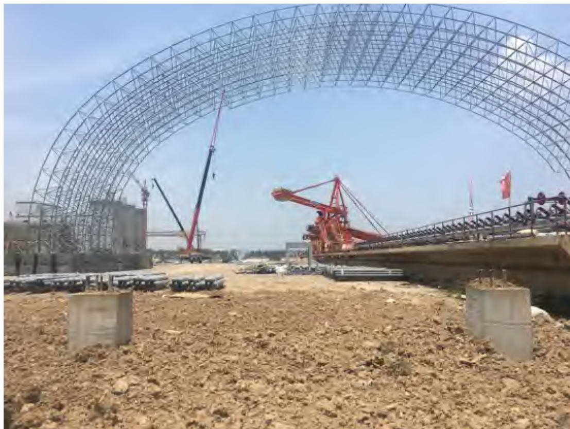
图 3-3 陆域堆场区地表裸露遇雨容易产生土壤侵蚀
