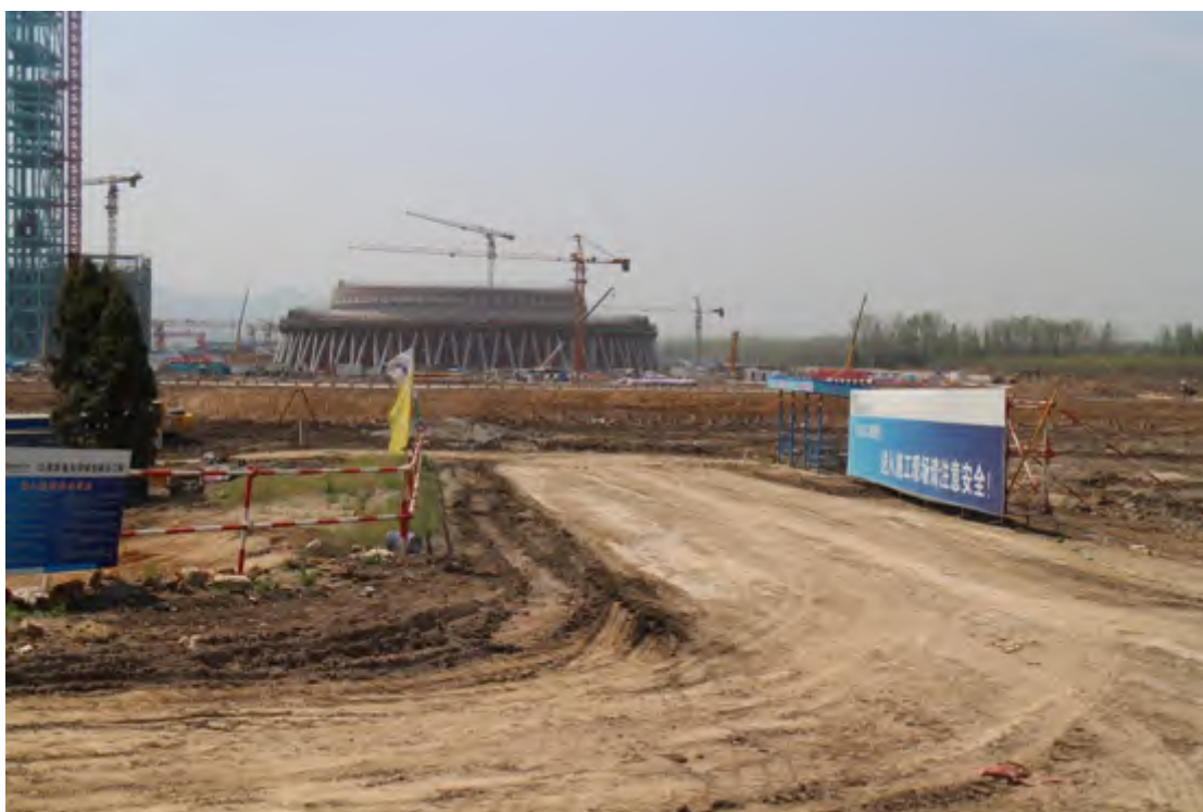
图 3-1 第一季度陆域堆场区水土流失现状
