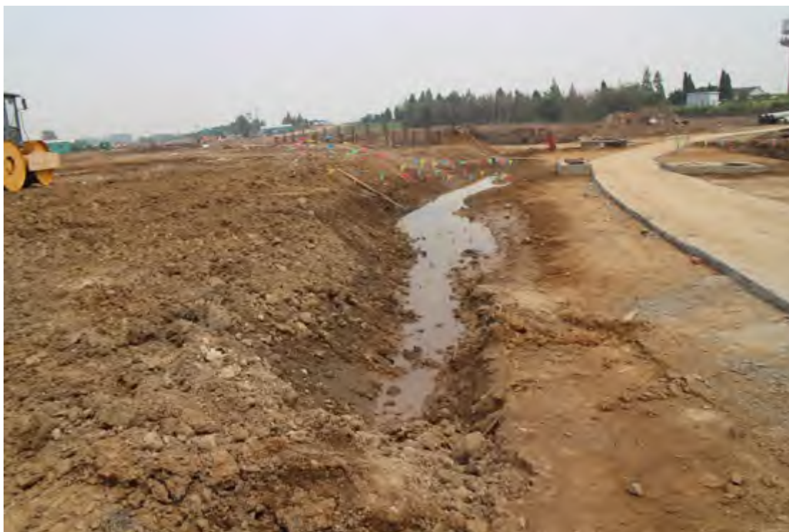
图 3-3 本季度项目区小部分排水沟泥沙淤积
