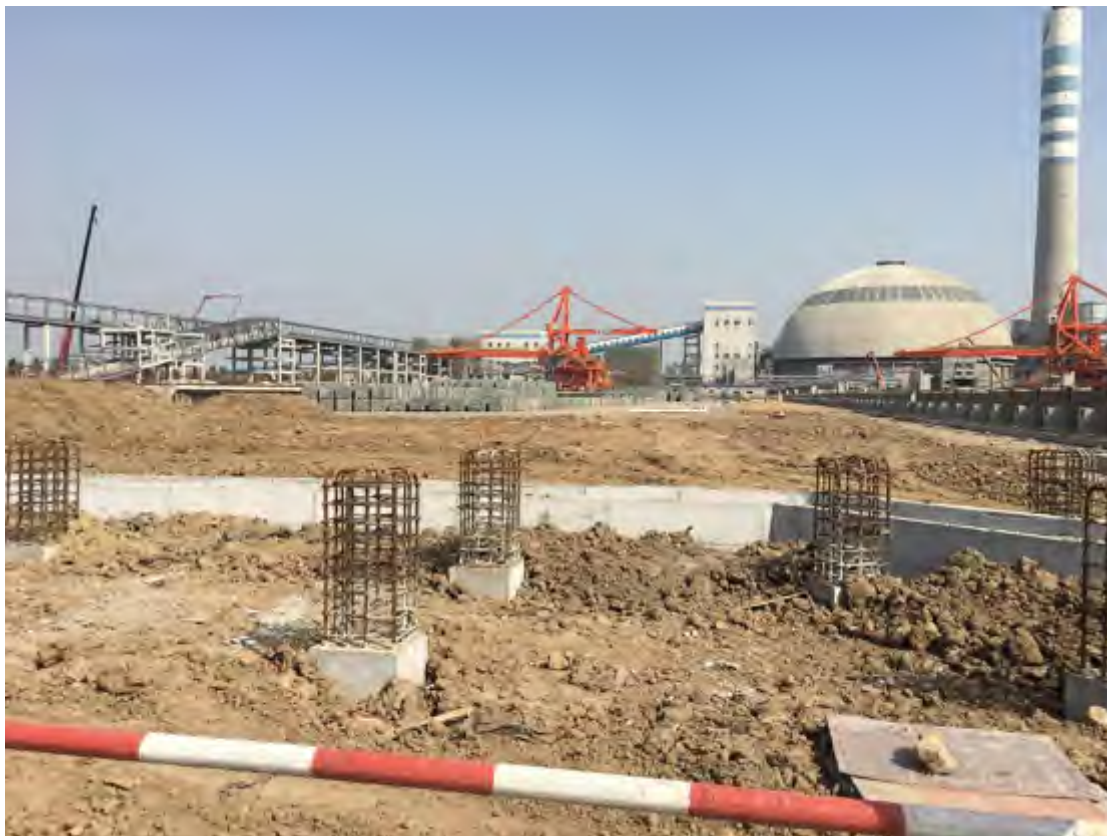
图 3-1 第一季度陆域堆场区水土流失现状
