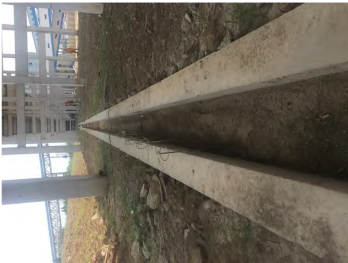
图 3-4 进场道路区部分排水沟存在一定的泥沙淤积现象（测钎法）
