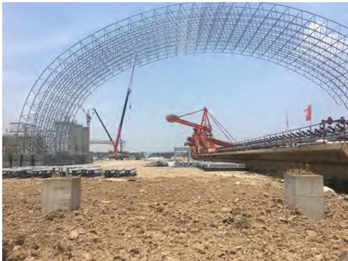
图 5-1 陆域堆场区部分裸露地表未及时做好苫盖等防护措施
