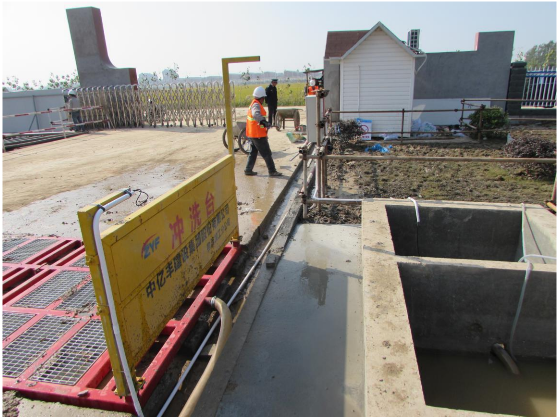
2016.11.3 入口处洗车平台及沉砂池
