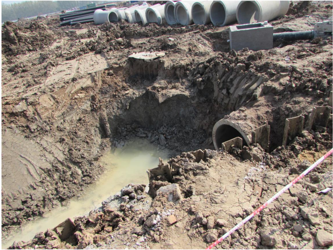
2016.11.3 场地内临时排水
