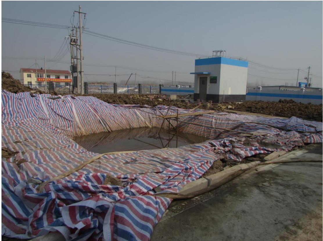
2017.6 场地内临时沉砂池
