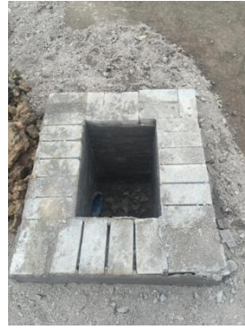
站内排水设施
