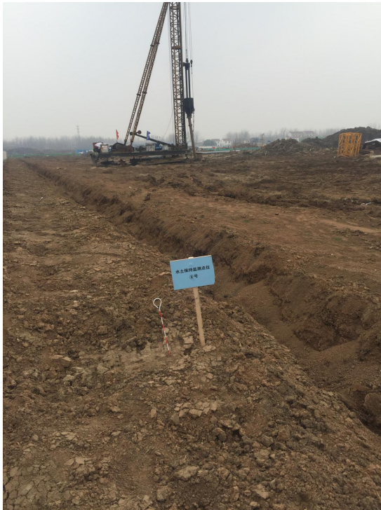
2017.1.19 蓄水泵房监测点位
